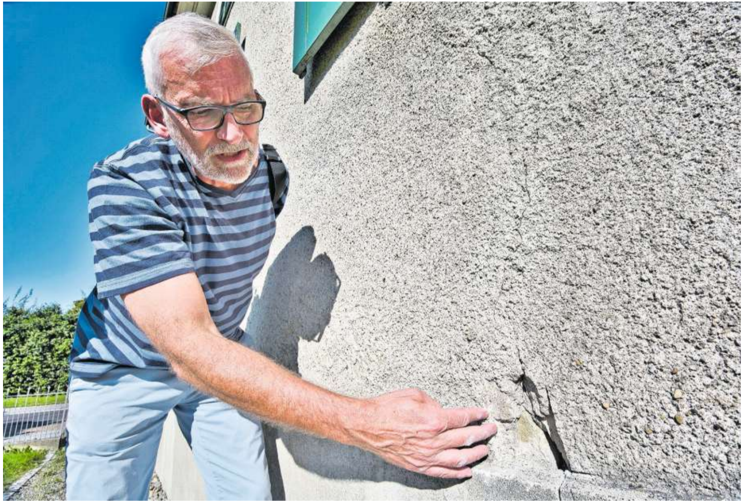
Anhand einer rissigen Stelle an der Westwand des Schulmuseums Mühlebach zeigt Dominik Joos wie das Mauerwerk aufgebaut ist. Der gestampfte Lehm der Pisébauweise muss mit einem rund vier bis fünf Zentimeter dicken Verputz geschützt werden. Bild: Manuel Nagel
